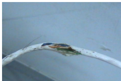
Gb. 1. Kabel terkelupas
